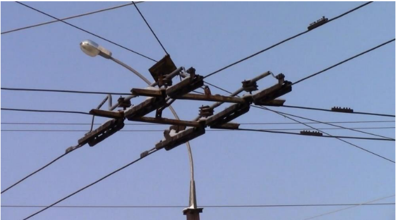
Рис. 3.2. Линии электропитания троллейбусов
