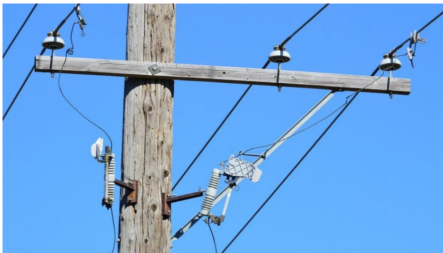
Рис. 1.3. Внешний вид воздушной линии электропередачи с деревянной опорой
