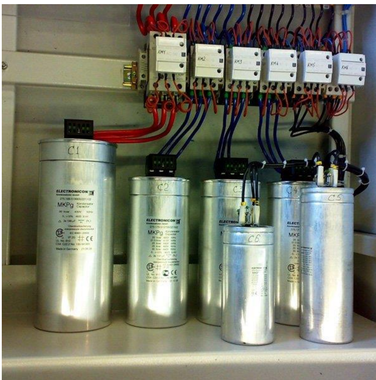
Рис. 3.16. Батарея конденсаторов для компенсации реактивной мощности в СЭС
