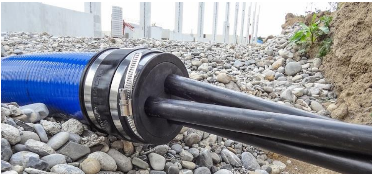
Рис. 1.18. Внешний вид кабеля в полимерной трубе
