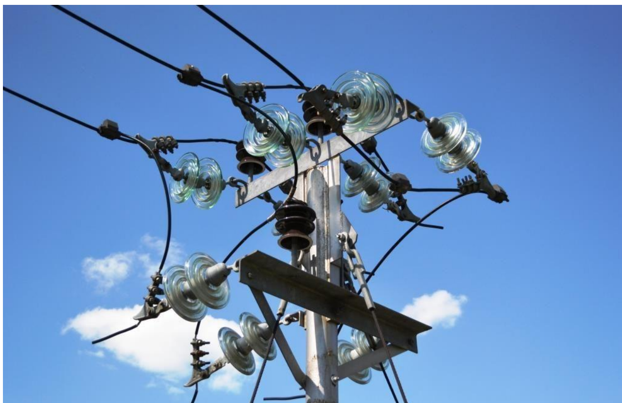
Рис. 1.11. Внешний вид конструктивного обвеса воздушной линии электропередачи
