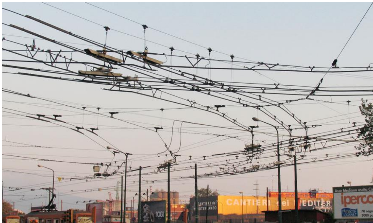
Рис. 3.1. Линии электропитания троллейбусов
