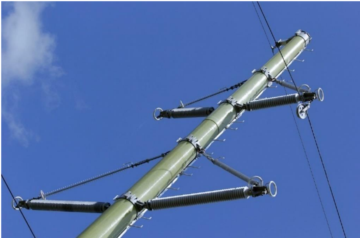
Рис. 1.6. Внешний вид воздушной линии электропередачи с полимерной опорой
