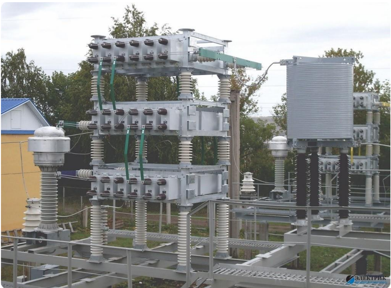
Рис. 3.19. Батарея конденсаторов для компенсации реактивной мощности в СЭС на подстанции
