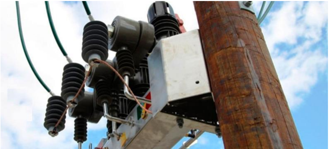
Рис. 1.13. Внешний вид воздушной линии электропередачи с установленным реклоузером
