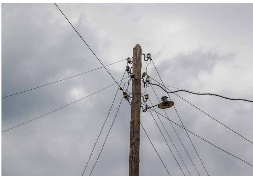
Рис. 1.4. Внешний вид воздушной линии электропередачи с деревянной опорой
