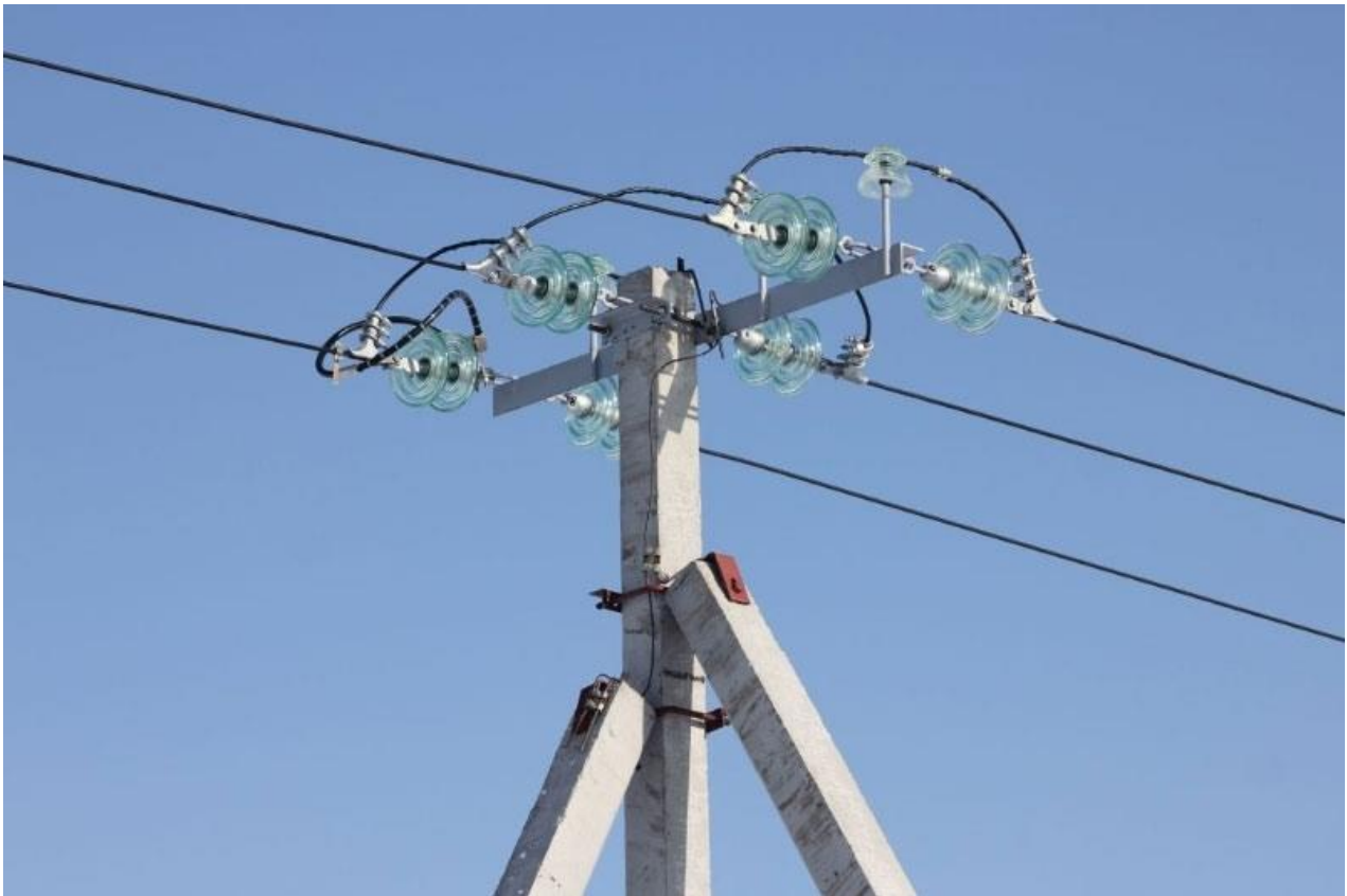
Рис. 1.5. Внешний вид воздушной линии электропередачи с железобетонной опорой ЛЭП
