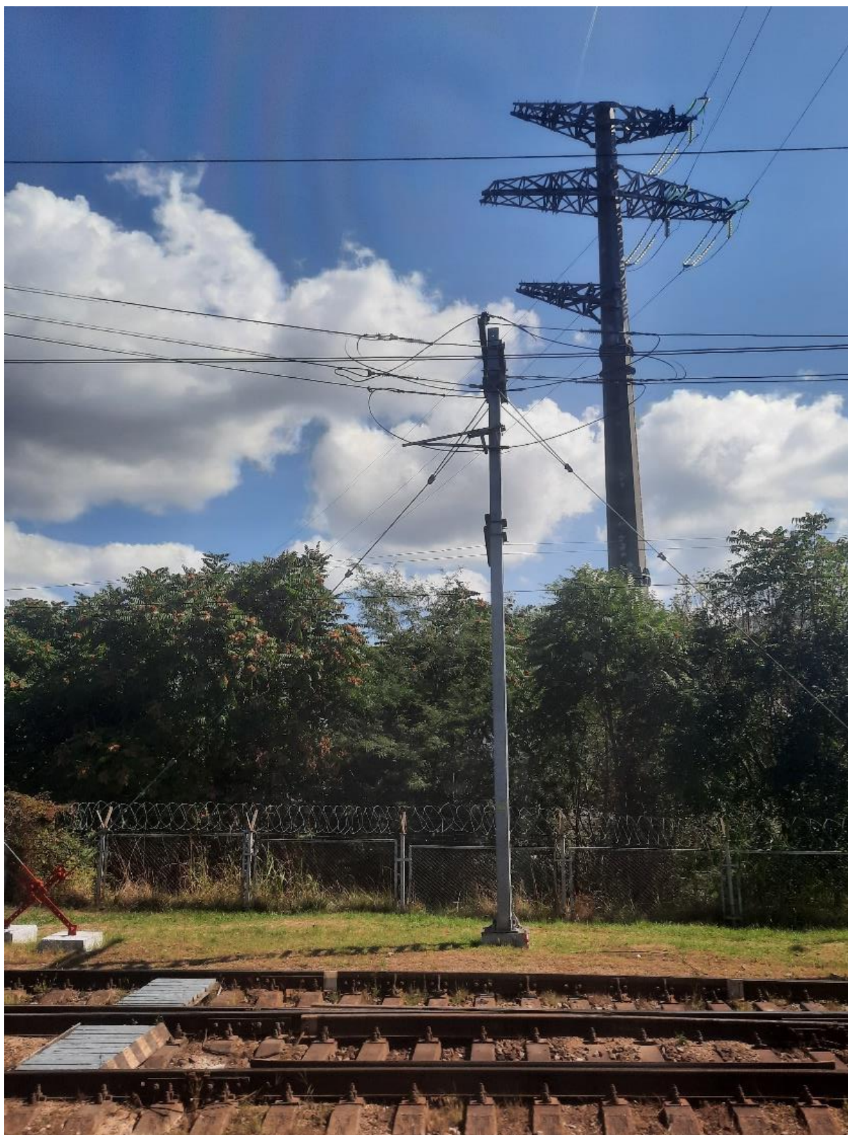
Рис. 1.7. Внешний вид воздушной линии электропередачи с металлической опорой
