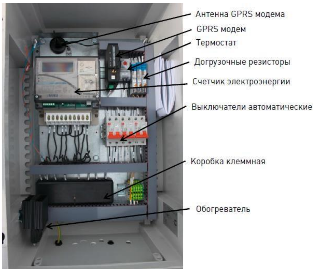
Рис. 1.14. Шкаф управления реклоузером
