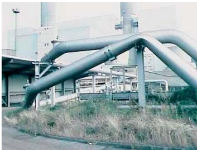
Рис. 6.4. Полностью разрушенная напорная труба DN 600 мм (толщина стенок 12 мм)
