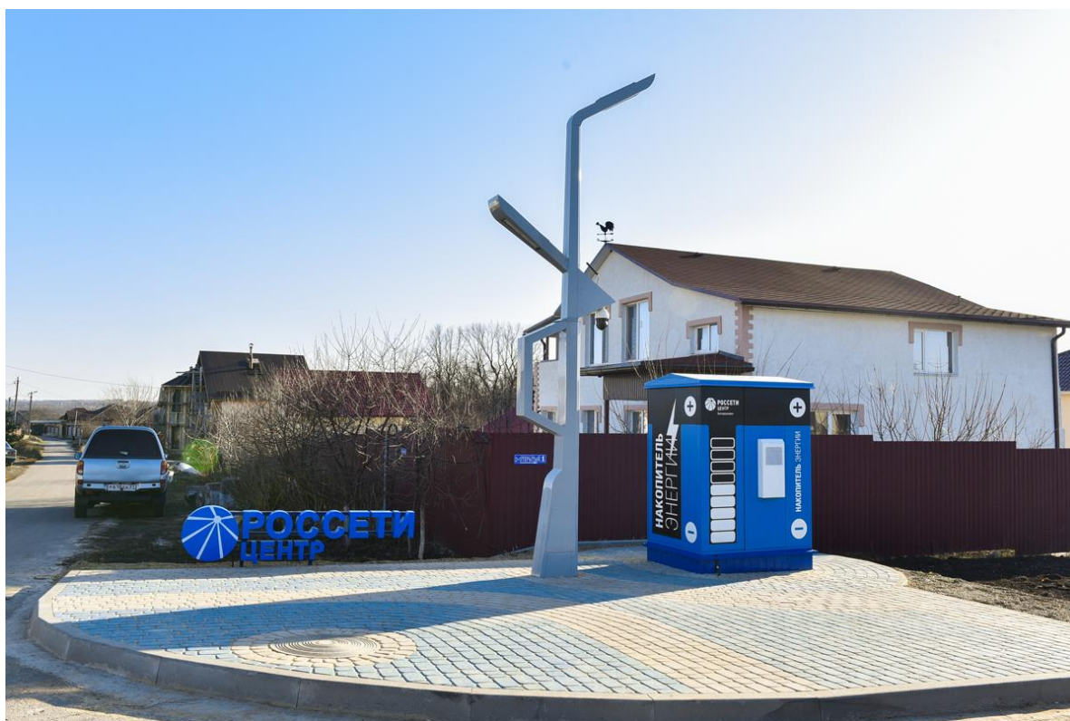
Рис. 1. Внешний вид накопителя электроэнергии в филиале ПАО «Россети Центр»-«Белгородэнерго»
