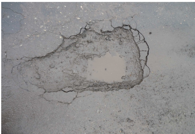
Рис. 1.1. Разрушение дорожного покрытия за счет недоуплотнения основания покрытия
