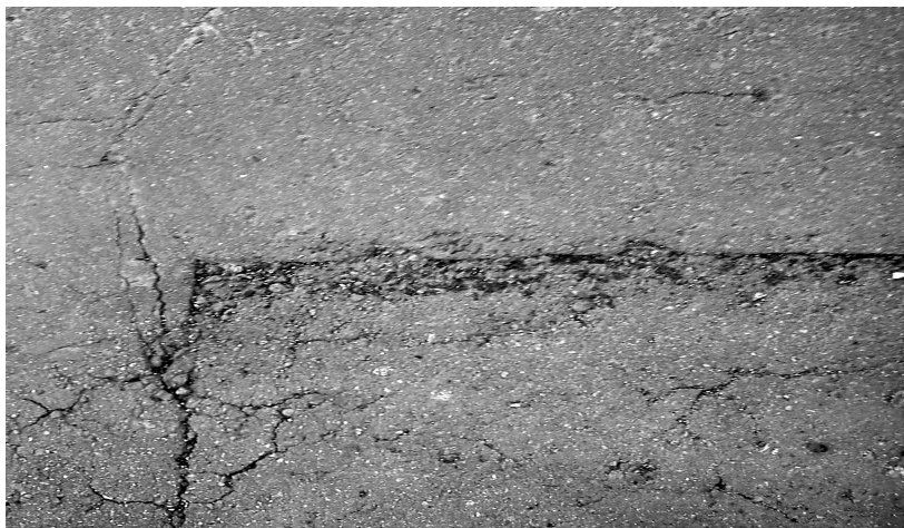
Рис. 3.19. Разрушение асфальтобетона в выбоине в зоне контакта с покрытием
