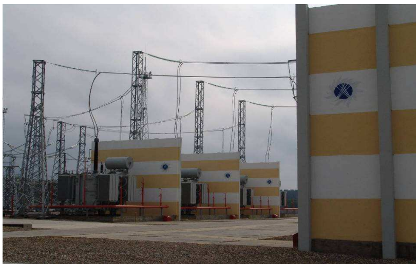
Рис. 1.12. Подстанция 500 кВ, Звезда, Волго-Окское ПМЭС
