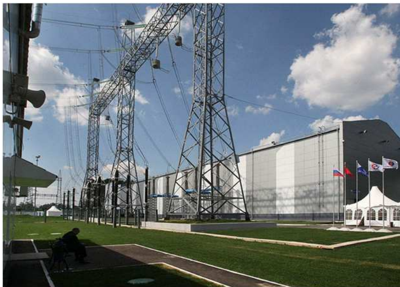
Рис. 4.8. Подстанция 500 кВ, Западная
