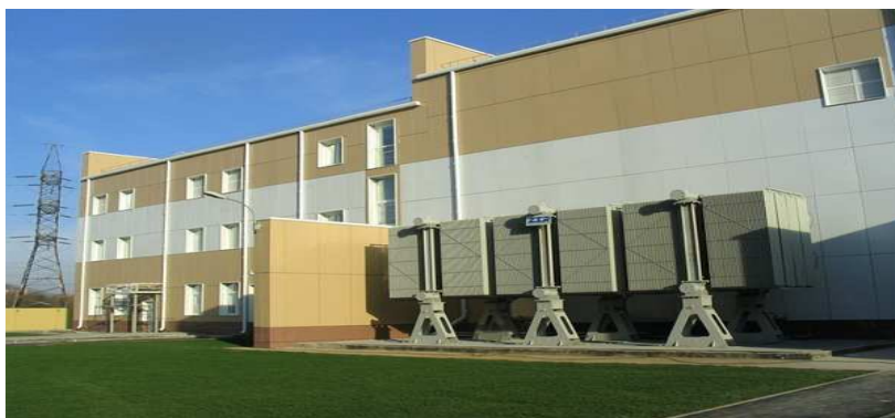
Рис. 4.6. Подстанция 500 кВ, Очаково
