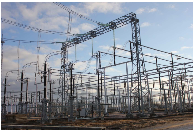
Рис. 1.11. Открытое распределительное устройство ПС 500 кВ, Дорохово, Московское ПМЭС
