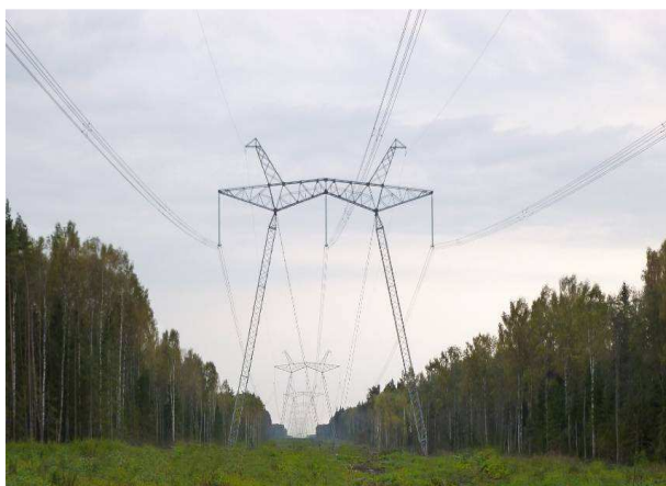
Рис. 1.15. Воздушная линия электропередачи 750 кВ «Калининская АЭС – Грибово»
