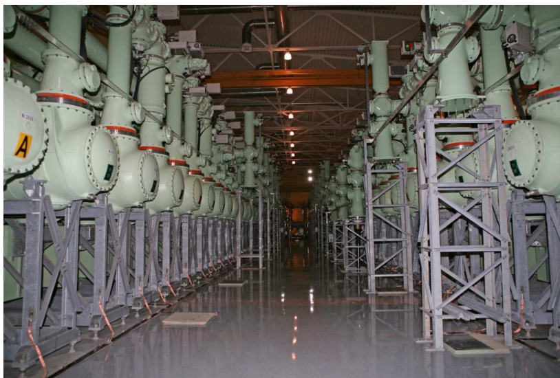
Рис. 1.13. Комплектное распределительное устройство ПС 550 кВ, Бескудниково, Московское ПМЭС
