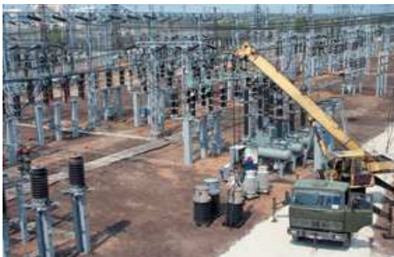
Рис. 4.7. Подстанция 500 кВ, Чагино
