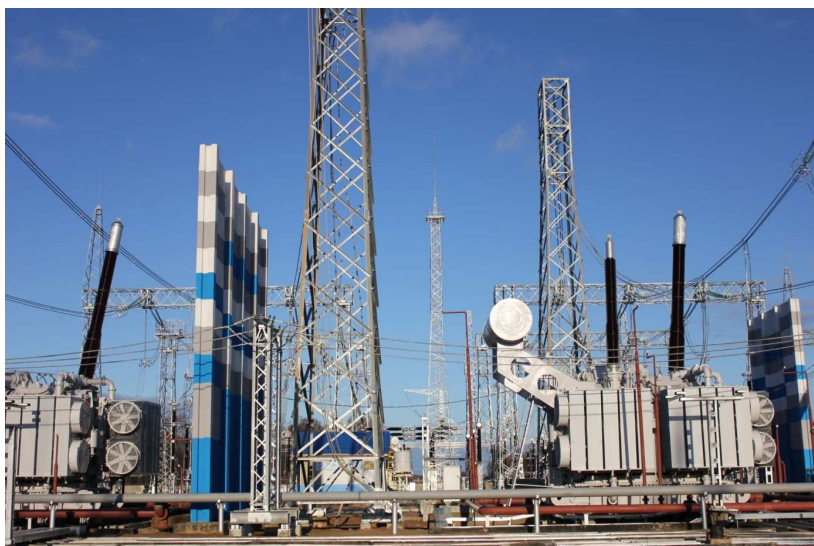
Рис. 1.10. Подстанция 750 кВ, Грибово, Московское ПМЭС
