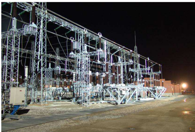
Рис. 4.9. Подстанция 750/500 кВ, Белый Раст (ОРУ 110 кВ)
