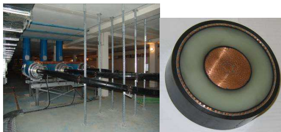
Рис. 1.16. Высоковольтные кабели из сшитого полиэтилена (заходы линий электропередачи на московские подстанции 500 кВ нового поколения сооружаются в кабельном исполнении)
