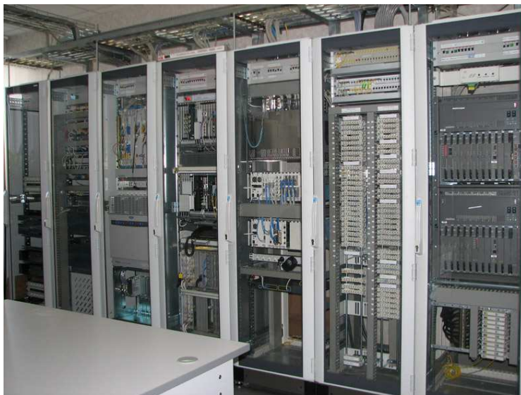
Рис. 1.3. Центральный узел связи МЭС Центра, ОУС Центра ЕЦССЭ – линейно-аппаратный зал связи (слева направо: серверный шкаф, шкаф ЛВС, шкаф магистральных мультиплексов, два шкафа мультиплексов доступа, кроссовый шкаф, шкаф ЕЦССЭ)
